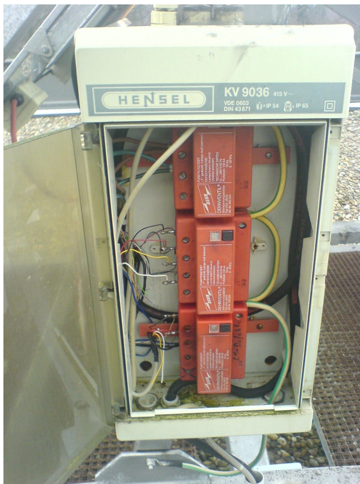
Abbildung 25: Zustand des Überspannungsschutzes II
