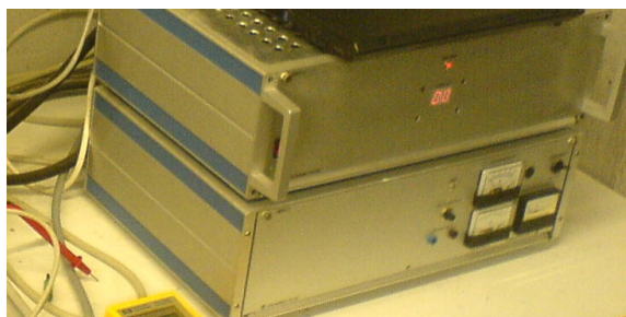
Abbildung 22: oben: Messwandler und Laderegung -- unten: Messeinrichtungen, Ladeüberwachung und Laststeuerung
