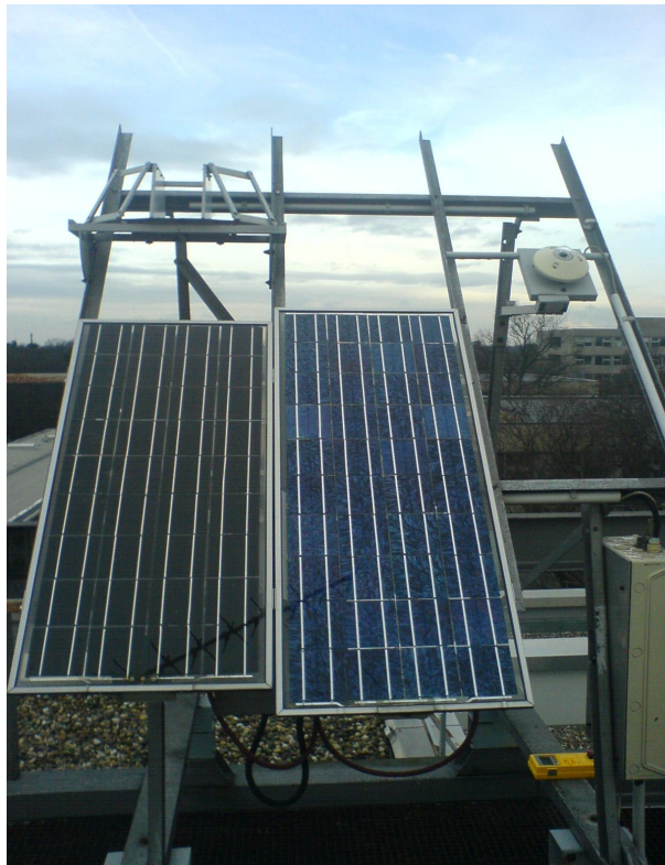
Abbildung 21: Solaranlage auf dem Dach des E-Gebäudes
